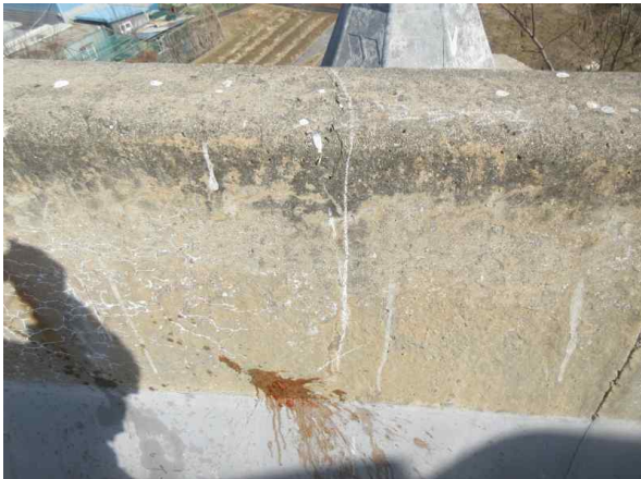
방호벽 균열(0.3mm미만) S1
