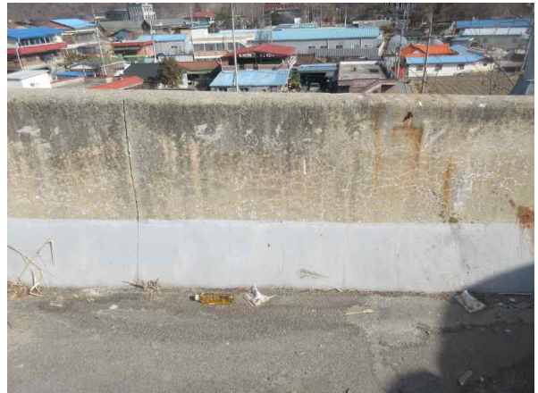
방호벽 망상균열 및 백태 S1
