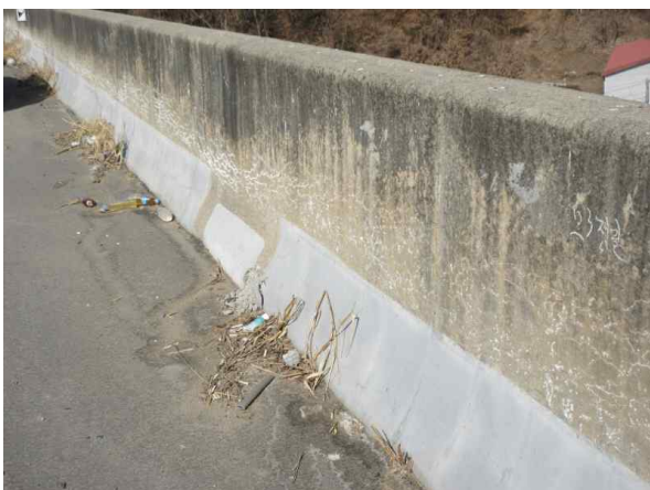
방호벽 망상균열 및 백태 S1
