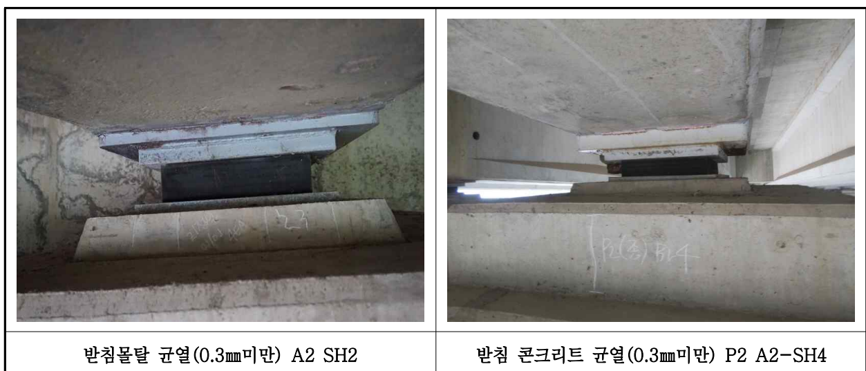
【사진 3.3.13】 교량받침 손상현황
